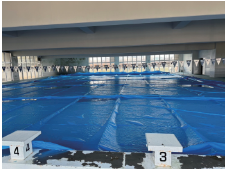
▲県立添上高校 老朽化したプール
